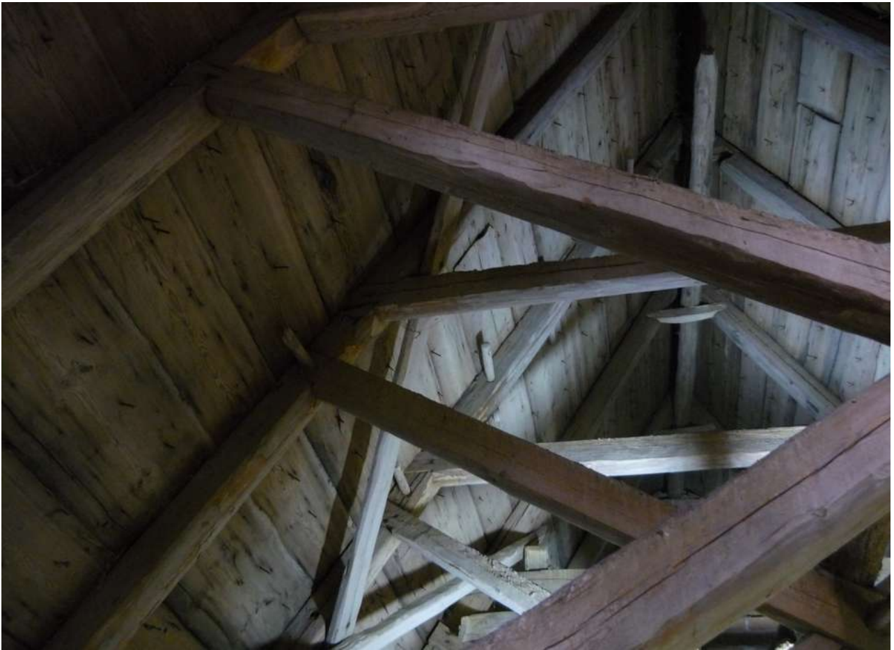
Kuvassa on Akaan kivisakastin kuudesta veistettyjä, hyväkuntoisia kattorakenteita. Selkäpuissa erottuvia tappeja on ilmeisesti käytetty myös tikkaina. Kuva: arkkitehtitoimisto Livady
