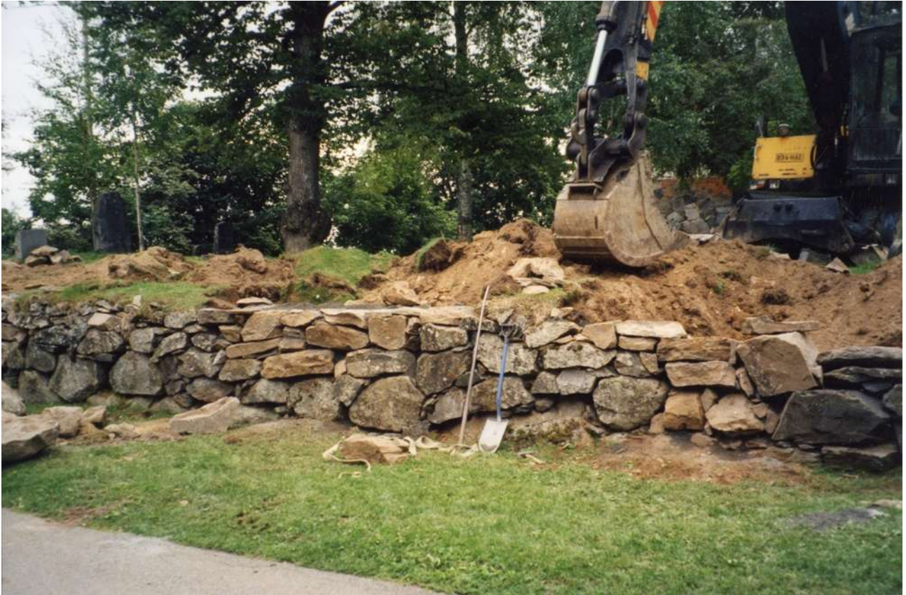
Pahimmat vauriot itäpuolen aidassa, jotka on aiheuttanut maan painon ja juuret. Aidan korjausta kesällä 2003. Veikko Luukkasen kaivinkonetta varten tehtiin maasilta hautausmaalle.
