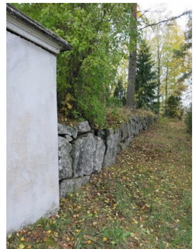
13 Koulutien puoleisen kiviaidan pullistuma, jonka on aiheuttanut koivun juuret.
