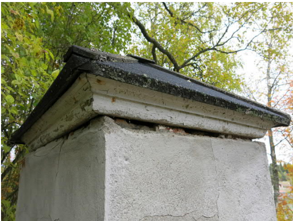
12 Nykyisen sisäänkäynnin pylvään vaurio.
